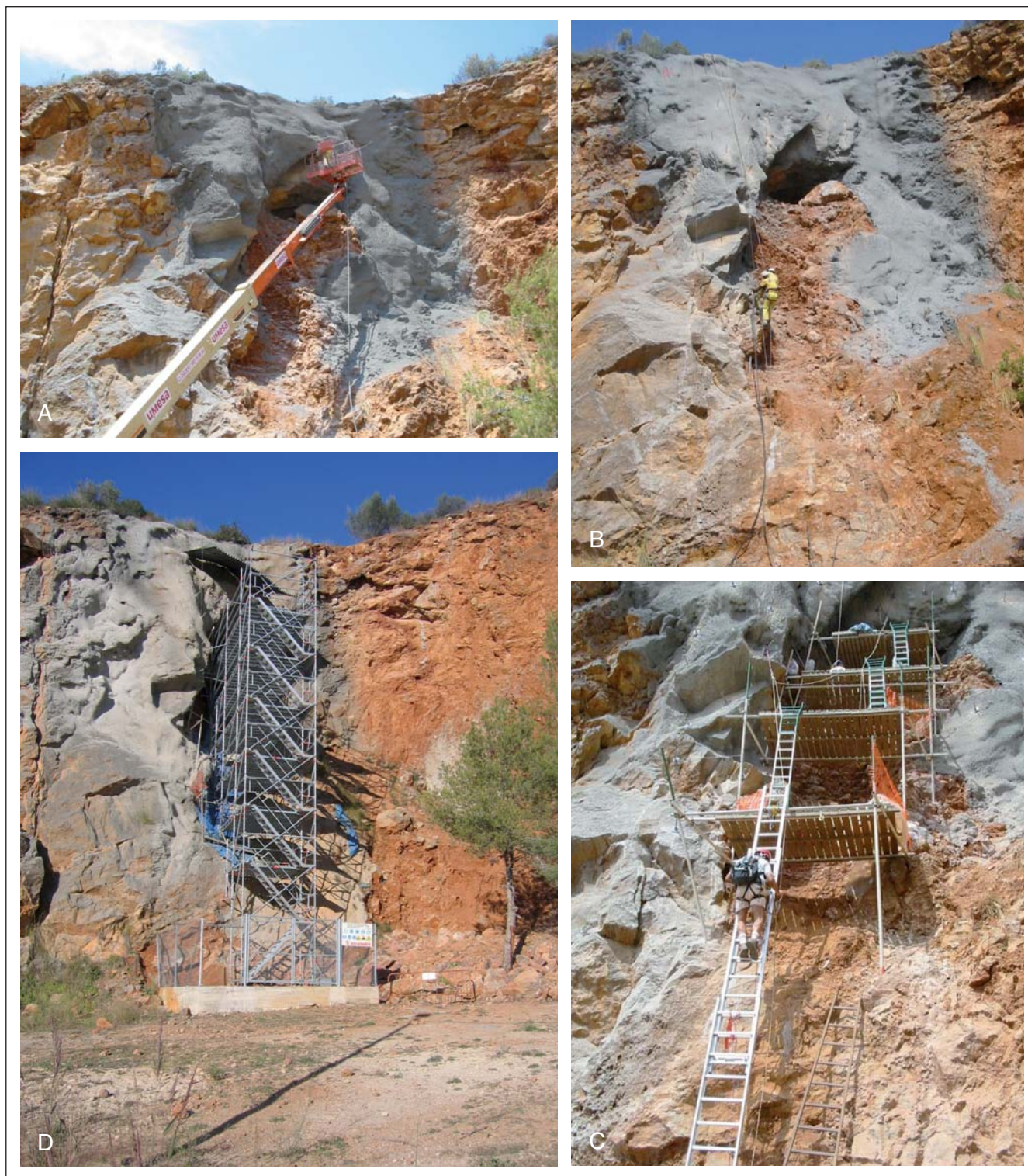
Fig. 5. Proceso de los trabajos de rehabilitación del yacimiento. A. Protección de los sedimentos, instalación de mallazo y proyectado de hormigón. B. Instalación de bulones de anclaje. C. Andamio de acceso provisional (años 2003-2006). D. Estado actual del yacimiento. Se construyó una plataforma de hormigón al pie del talud y se montó un andamio para acceder a la cueva (2007).
